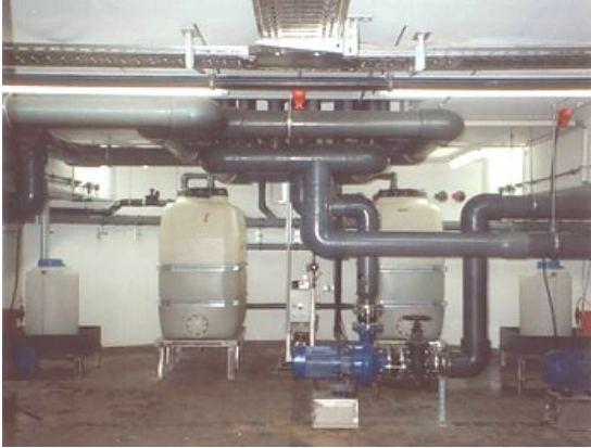
Unterirdische Pumpenstube. Bildnachweis INTEC
